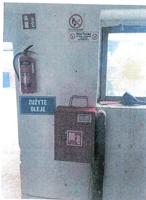
Foto.9. Hydrant wewnętrzny w budynku produkcyjno-magazynowym
