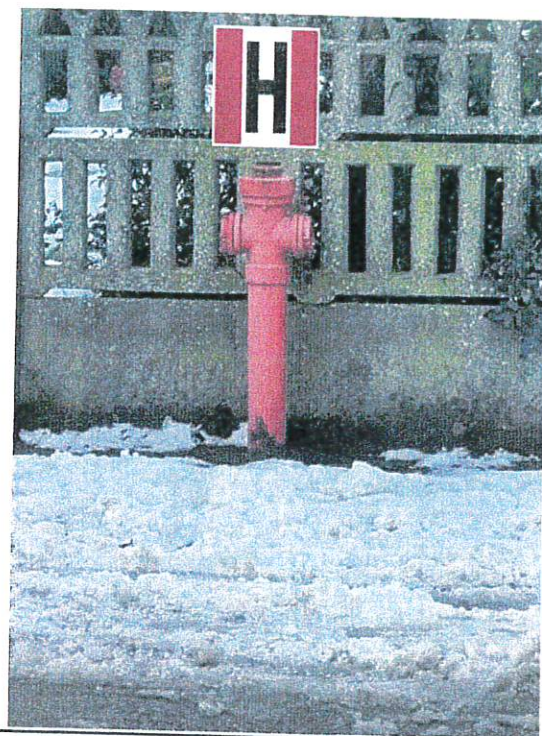
Foto.10. Hydrant zewnętrzny nadziemny DN80 nr 1.
