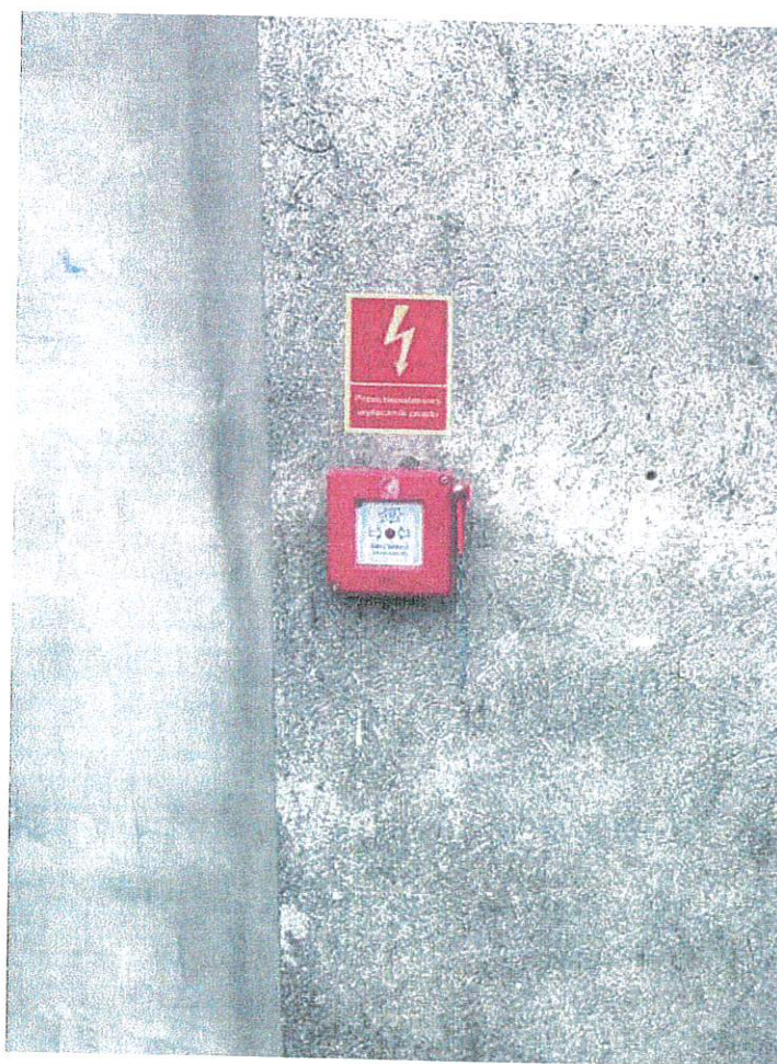
Foto.8. Miejsca usytuowania przeciwpożarowego wyłącznika prądu
