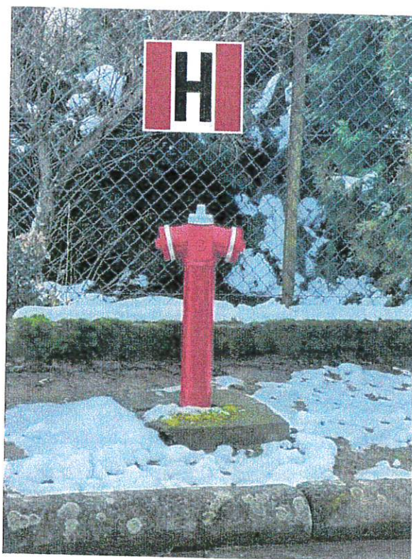
Foto.11. Hydrant zewnętrzny nadziemny DN80 nr 2.
