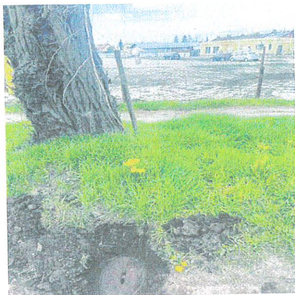
Foto. 2 Widok hydrantu podziemnego przy ul. Piasta
