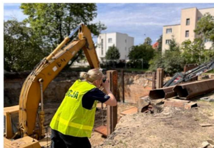
Miejsce śmiertelnego wypadku na budowie na pl. Weysenhoffa w Bydgoszczy
