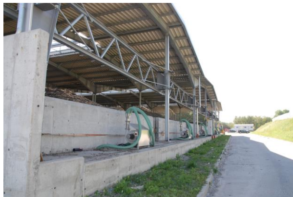
Rysunek 136 Instalacja do stabilizacji biologicznej odpadów – proces suszenia, Wawrzynki (sierpień 2013r)
