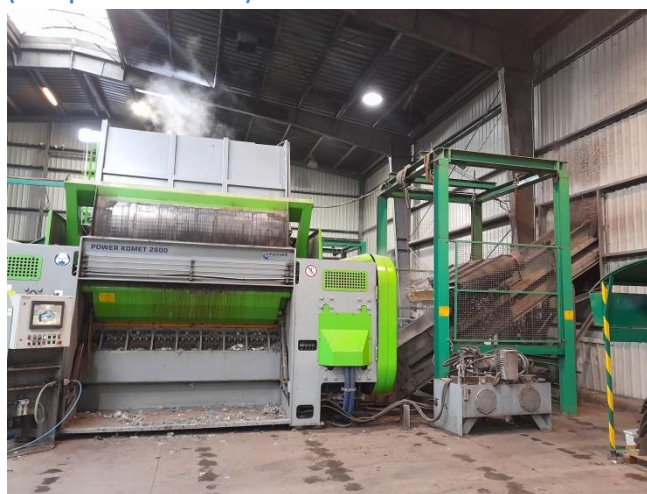
Rysunek 143 Instalacja produkcji paliwa alternatywnego (foto: październik 2021r)
