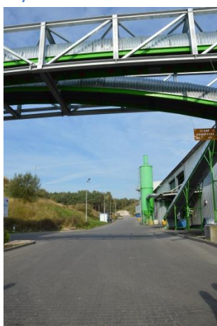
Rysunek 27 Taśmociąg łączący halę sortowni odpadów zmieszanych z halą sortowni doczyszczania odpadów surowcowych i frakcji balastowej (foto: Zakurzewo, październik 2021r.)
