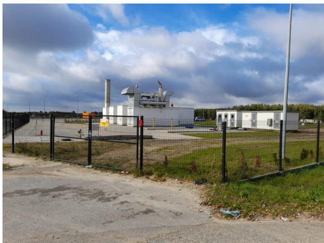
Rysunek 140 Instalacja energetycznego wykorzystania biogazu składowiskowego -ciepłownia (foto: październik 2021r)
