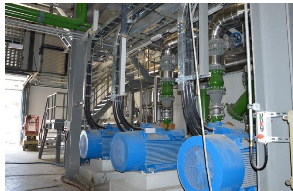
Rysunek 112 Tak jest. Spalarnia odpadów komunalnych, hala turbin, Bydgoszcz ProNatura ZTPOK (foto: Bydgoszcz, październik 2015r)
