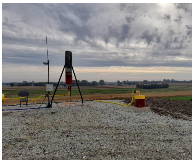
Rysunek 121 Pochodnia systemu odgazowania kwatery nr 3 (foto: Służewo, październik 2021r.)
