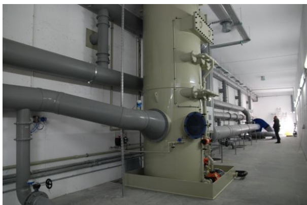
Rysunek 79 Instalacja stabilizacji frakcji biodegradowalnej wydzielonej ze zmieszanych odpadów komunalnych- system wentylacji, CORIMP Bydgoszcz (sierpień 2013r)
