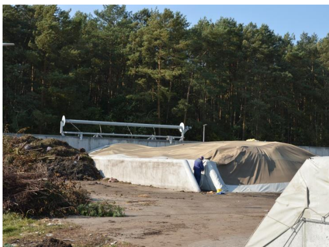
Rysunek 57 Instalacja do biologicznego przetwarzania odpadów z możliwością kompostowania odpadów zielonych, Puszcza Miejska (foto: Puszcza Miejska, październik 2021r.
