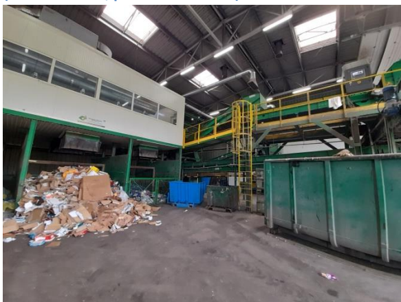
Sortownia odpadów komunalnych (zmieszanych i surowcowych), Bładowo (foto: Bładowo, październik 2021r).
