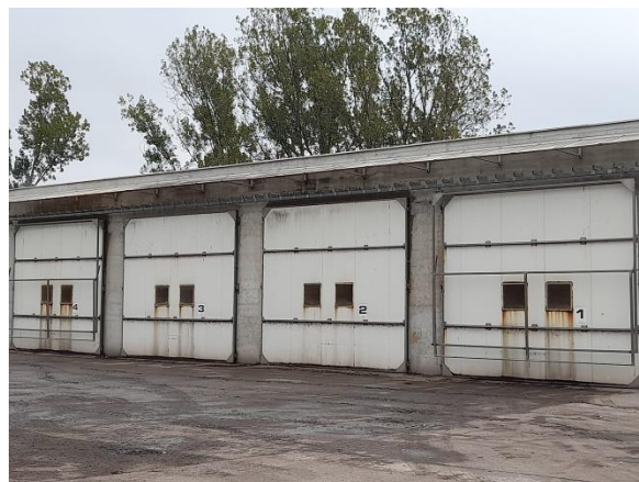
Instalacja do biologicznego przetwarzania odpadów z możliwością kompostowania odpadów zielonych, Bładowo (foto: Bładowo, październik 2021r).
