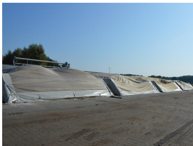
Rysunek 58 Instalacja do biologicznego przetwarzania odpadów z możliwością kompostowania odpadów zielonych, Puszcza Miejska (foto: Puszcza Miejska, październik 2021r.
