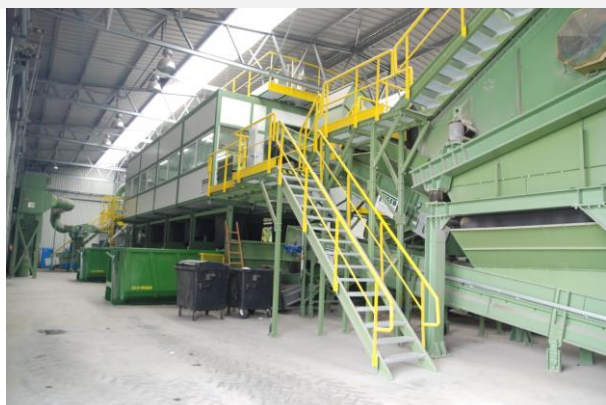
Rysunek 41 Sortownia odpadów komunalnych, Nedźwiedź (sierpień 2013r)
