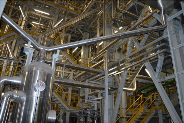
Rysunek 109 Spalarnia odpadów komunalnych, hala technologiczna pieca, Bydgoszcz ProNatura ZTPOK (foto: Bydgoszcz, październik 2015r)
