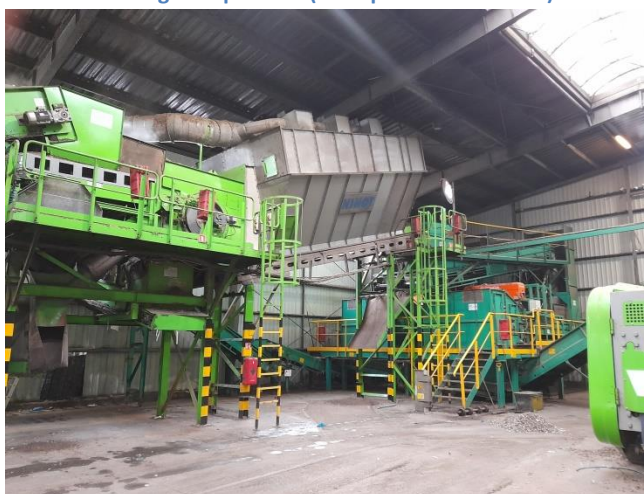
Rysunek 142 Instalacja produkcji paliwa alternatywnego (foto: październik 2021r)
