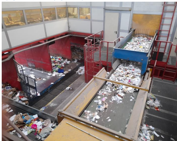
Rysunek 106 Sortownia odpadów komunalnych ProNatura_ Bydgoszcz (foto: Bydgoszcz, październik 2021r.)
