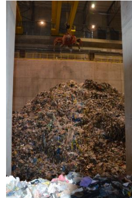
Rysunek 110 Spalarnia odpadów komunalnych, bunkier zasypowy odpadów, Bydgoszcz ProNatura ZTPOK (foto: Bydgoszcz, październik 2015r)
