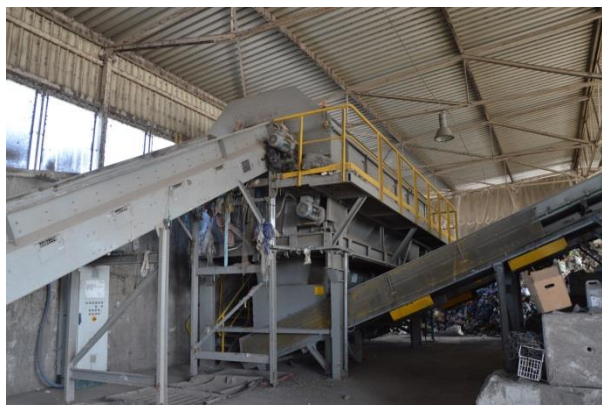
Rysunek 86 Sortownia odpadów komunalnych zmieszanych (sortowanie wstępne), Remondis Bydgoszcz (foto: Remondis Bydgoszcz, październik 2015r)
