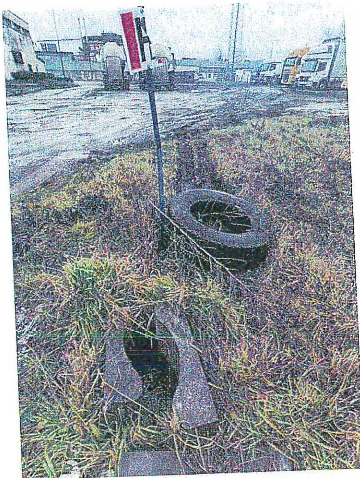
Foto.5 Wygląd hydrantu zewnętrznego podziemnego nr 2
