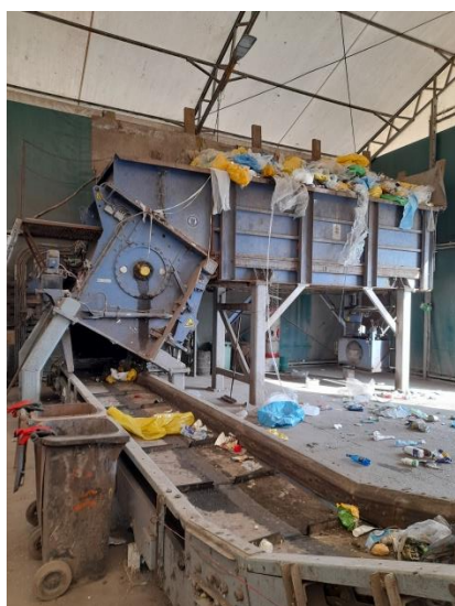
Rysunek 121 Sortownia odpadów zmieszanych i selektywnie zebranych- rozrywarka worków, Służewo (foto: Służewo, październik 2021r.)
