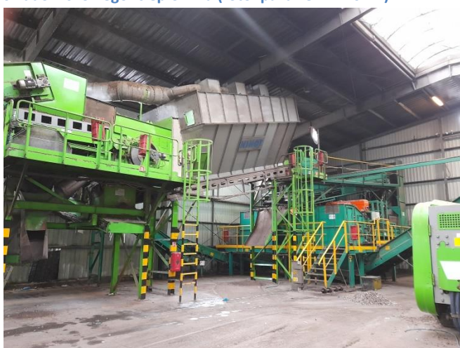
Rysunek 144 Instalacja produkcji paliwa alternatywnego (foto: październik 2021r)
