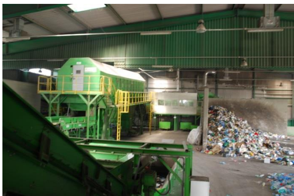
Rysunek 125 Sortownia odpadów komunalnych mieszanych i selektywnie zebranych, Toruń MPO (sierpień 2013r)
