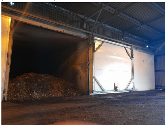
Rysunek 95 Instalacja stabilizacji frakcji biodegradowalnej wydzielonej ze zmieszanych odpadów komunalnych (foto: Remondis Bydgoszcz, październik 2021r. )
