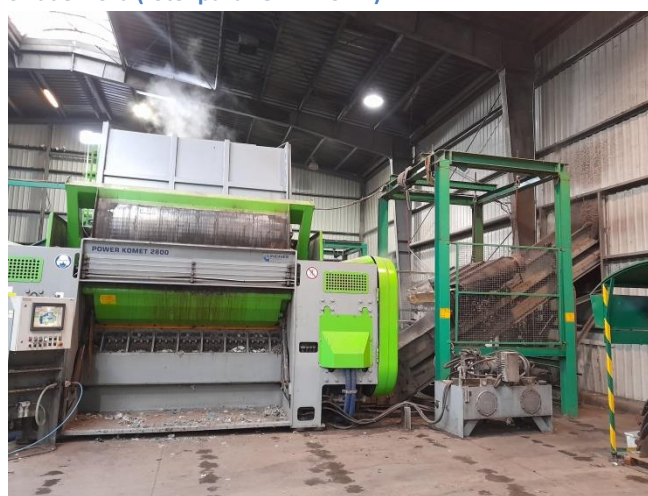
Rysunek 145 Instalacja produkcji paliwa alternatywnego (foto: październik 2021r)
