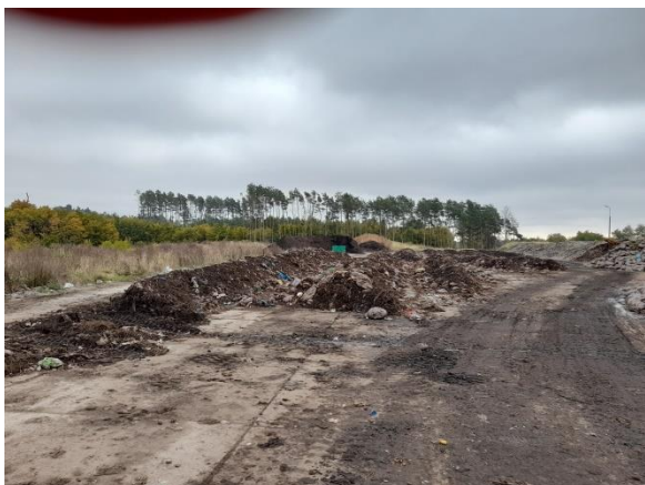
Polowa kompostowania odpadów zielonych wraz z placem dojrzewania stabilizatu, Bładowo (foto: Bładowo, październik 2021r).
