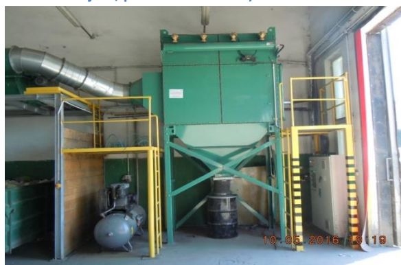
Rysunek 52 Sortownia odpadów komunalnych zmieszanych i selektywnie zebranych – separator powietrzny, Puszczza Miejska (foto. Puszczza Miejska, październik 2015r.)
