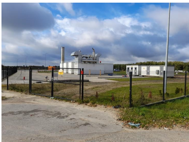
Rysunek 142 Instalacja energetycznego wykorzystania biogazu składowiskowego - ciepłownia (foto: październik 2021r)
