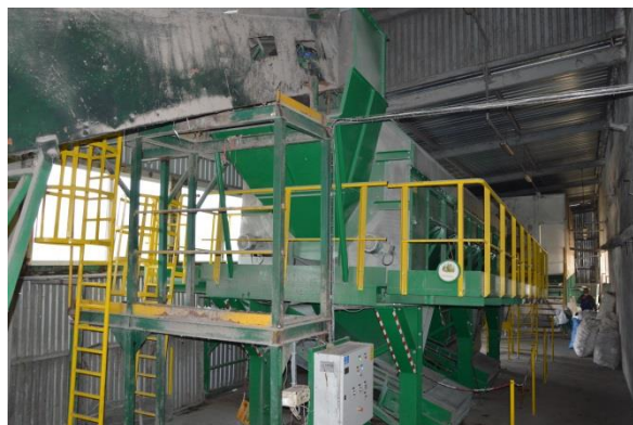
Rysunek 50 Sortownia odpadów komunalnych zmieszanych i selektywnie zebranych - sito bębnowe, Puszczza Miejska (foto. Puszczza Miejska, październik 2015r.)
