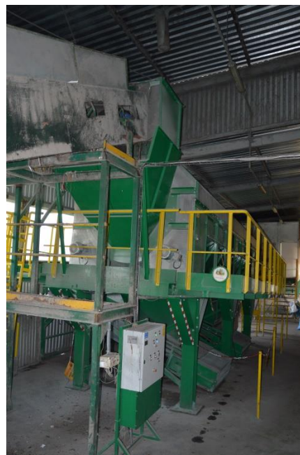
Rysunek 56 Sortownia odpadów komunalnych zmieszanych i selektywnie zebranych, Puszczka Miejska (foto. Puszczka Miejska, październik 2021r.)
