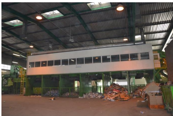
Rysunek 126 Sortownia odpadów komunalnych mieszanych i selektywnie zebranych, Toruń MPO (foto: Toruń, MPO, wrzesień 2015r)
