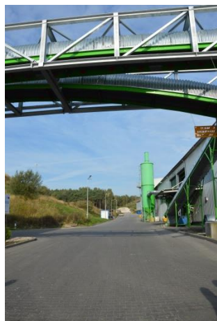
Rysunek 27 Taśmociąg łączący halę sortowni odpadów zmieszanych z halą sortowni doczyszczania odpadów surowcowych i frakcji balastowej (foto: Zakurzewo, październik 2021r.)
