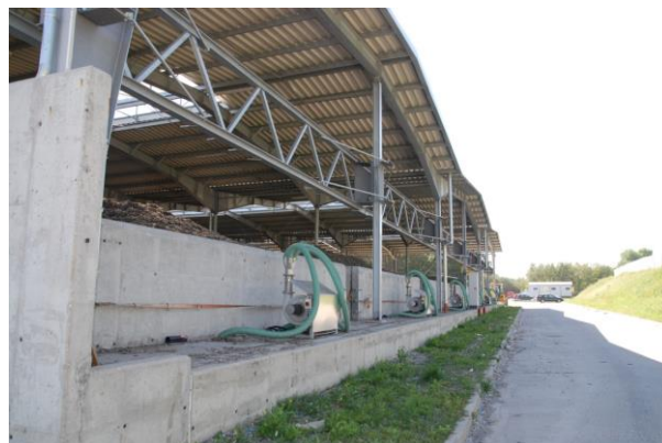
Rysunek 139 Instalacja do stabilizacji biologicznej odpadów – proces suszenia, Wawrzynki (sierpień 2013r)
