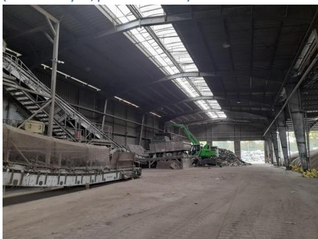
Rysunek 140 Instalacja do rozdrabniania i sortowania po lewej, reaktory stabilizacji biologicznej po prawej (foto: październik 2021r)
