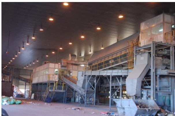
Rysunek 85 Sortownia odpadów komunalnych, Remondis Bydgoszcz (sierpień 2013r)
