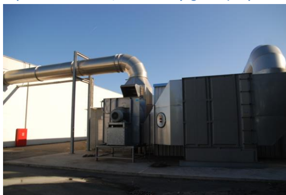
Rysunek 90 Instalacja stabilizacji frakcji biodegradowalnej wydzielonej ze zmieszanych odpadów komunalnych- system wentylacji, Remondis Bydgoszcz (sierpień 2013r)
