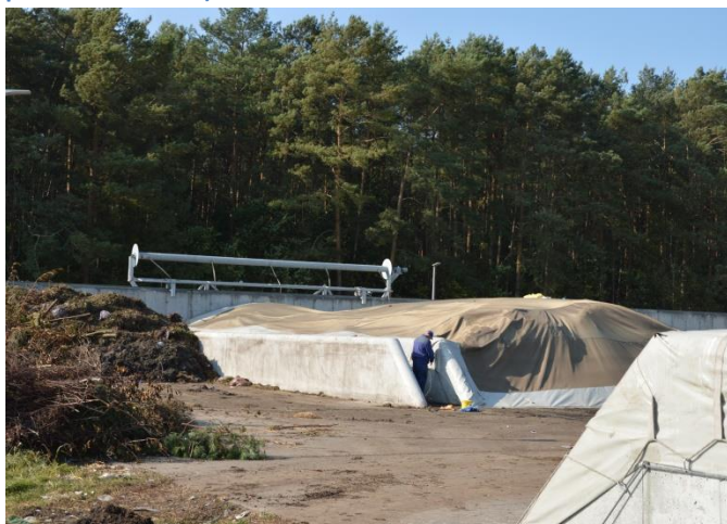
Rysunek 57 Instalacja do biologicznego przetwarzania odpadów z możliwością kompostowania odpadów zielonych, Puszczka Miejska (foto: Puszczka Miejska, październik 2021r.)
