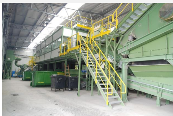
Rysunek 41 Sortownia odpadów komunalnych, Nedźwiedź (sierpień 2013r)
