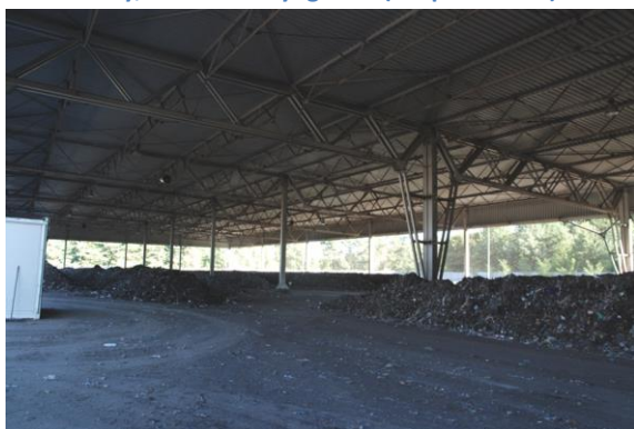
Rysunek 89 Instalacja stabilizacji frakcji biodegradowalnej wydzielonej ze zmieszanych odpadów komunalnych- plac pryzmowy zadaszony Remondis Bydgoszcz (sierpień 2013r)
