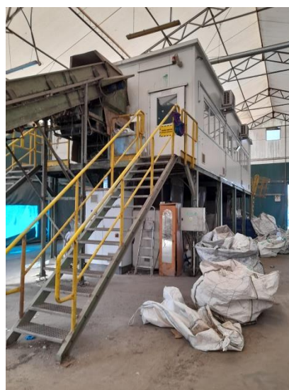
Rysunek 122 Sortownia odpadów zmieszanych i selektywnie zebranych- kabina sortownicza, Służewo (foto: Służewo, październik 2021r.)
