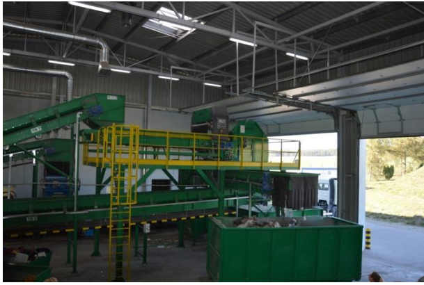
Rysunek 3 Nowa sortownia odpadów komunalnych (zmieszanych i surowcowych), Bładowo (foto: Bładowo, październik 2015r).
