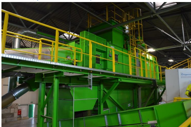
Rysunek 25 Sortownia do doczyszczania odpadów surowcowych i frakcji balastowej (foto: Zakurzewo, październik 2021r.)
