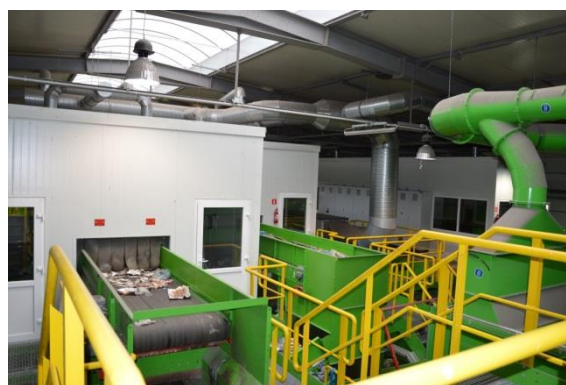
Rysunek 18 Nowa sortownia odpadów (komunalnych zmieszanych i surowcowych), Zakurzewo (foto: Zakurzewo, wrzesień 2015r).
