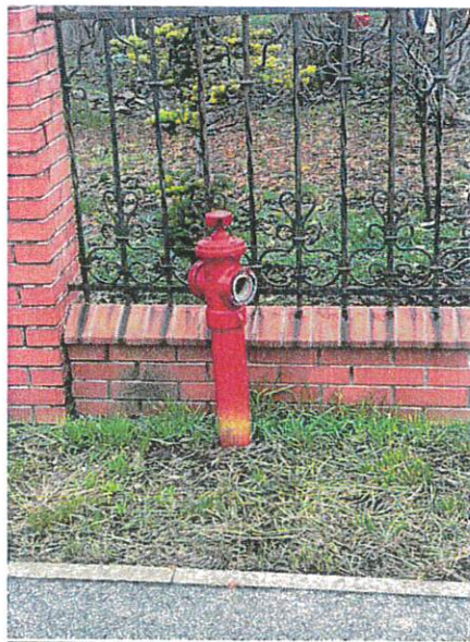
Foto.5. Hydrant zewnętrzny nadziemny DN80.
