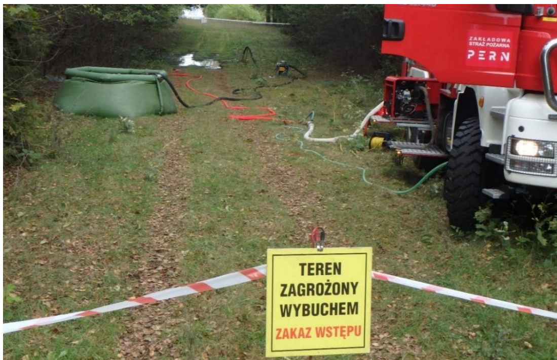
Zdjęcie nr 1. Wizja w terenie w dniu 07.10.2020 r. Odpompowywanie ropy do autocysterny z rozlewiska powstałego w związku z rozszczelnieniem rurociągu „Pomorskiego” PERN S.A. w m. Puszcza Miejska, gm. Rypin, powiat rypiński.
