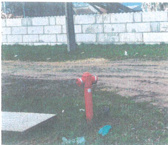
Widok na hydrant za zakładem
