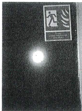
Zdjęcie Nr 4 drzwi EI 30 pomiędzy częścią PM a ZL
