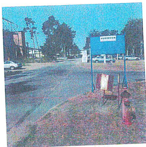
Hydrant DN 100 ul. Hechlińskiego
