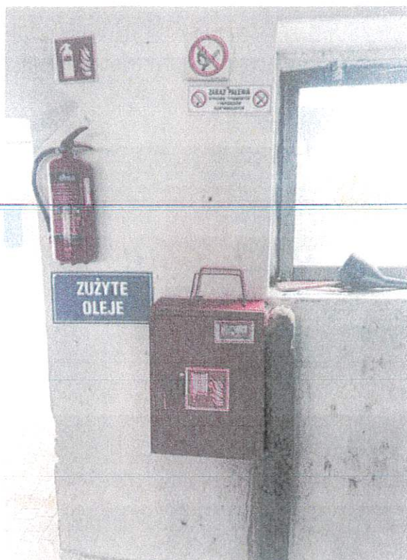
Foto.10. Hydrant wewnętrzny w budynku produkcyjno-magazynowym
