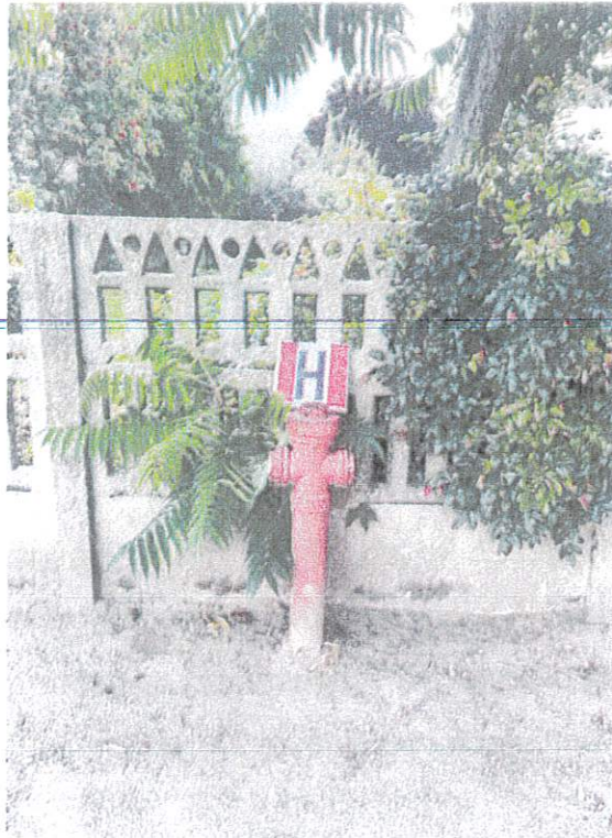
Foto.11. Hydrant zewnętrzny nadziemny DN80 nr 1.
