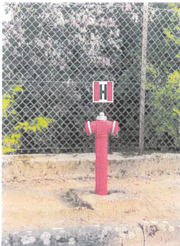
Foto.12. Hydrant zewnętrzny nadziemny DN80 nr 2.
